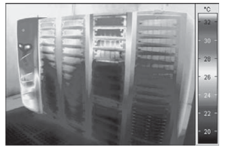
Mit der thermischen Analyse lassen sich Temperaturprobleme bei Server-Racks leicht erkennen. Foto: BS/Rittal
